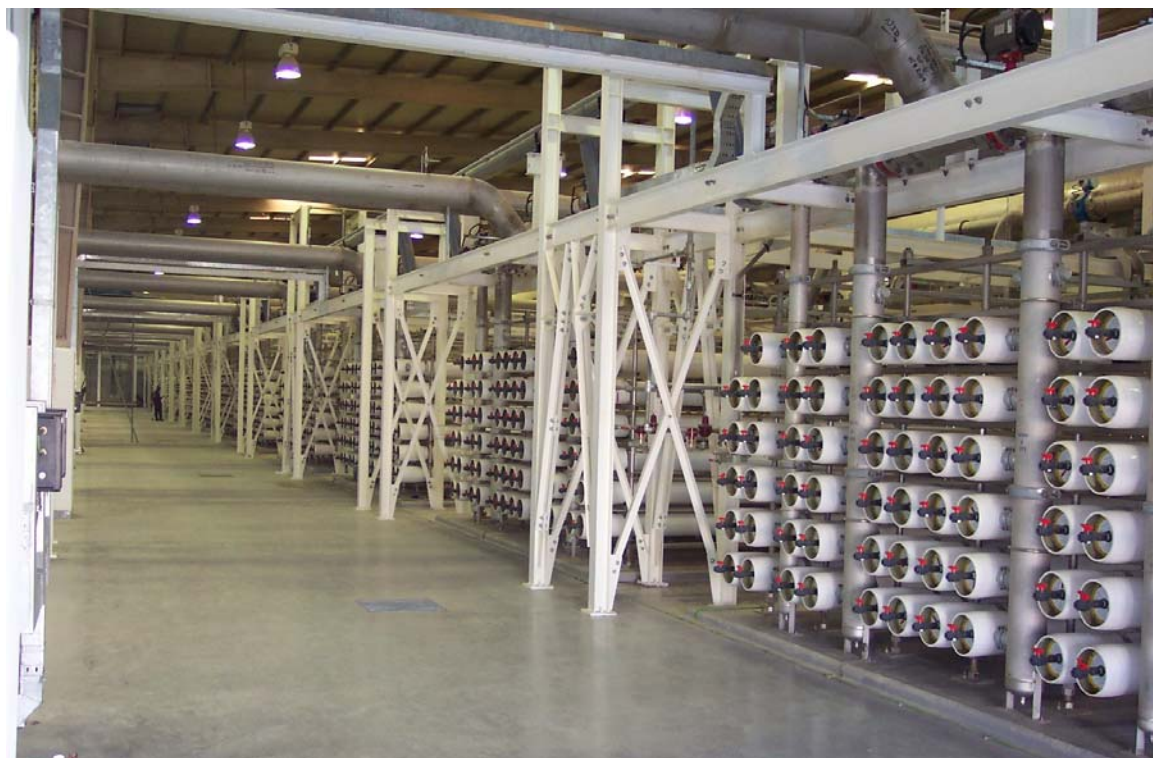
图 3 SULAIBIYA 污水回用膜法处理系统
